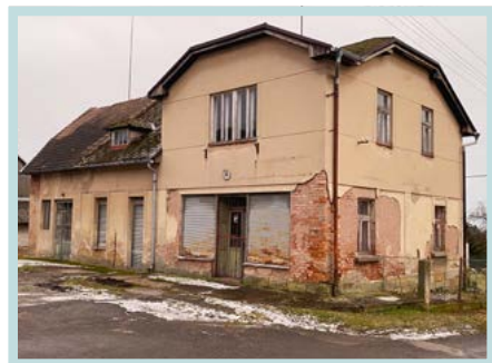
Na první pohled je každému jasné, že objekt je ve velmi špatném technickém stavu.
